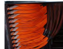
Pré-câblage Optique pages 60-61
